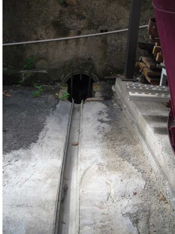
Foto 18: Scarico acque bianche nel piazzale del civico 106 di via Molassana
