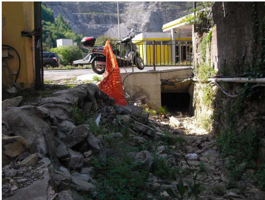
Foto 8: Sponda sinistra crollata e imbocco del tombino
